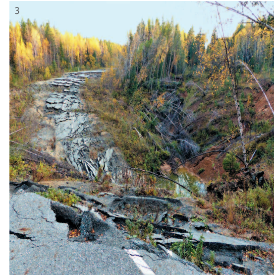
3. Провал автодороги в зоне обрушения Южной залежи шахты «Северопесчанская».
